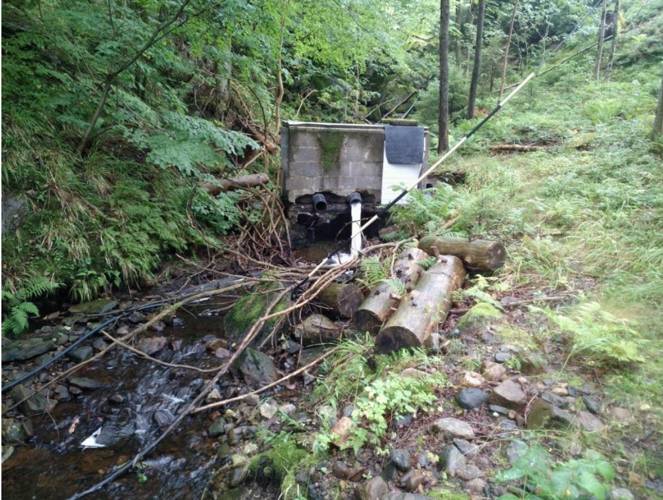
Mikrokraftverket på øvre del av el-fiskestasjonen.
