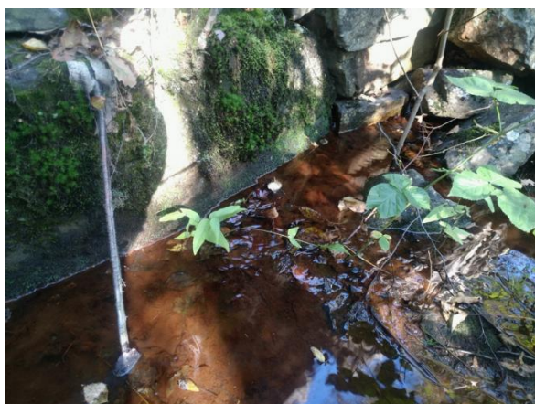
Bilde 1. Det er en liten lekkasje under dammen ved utløpet av Frøvik tjenn.
