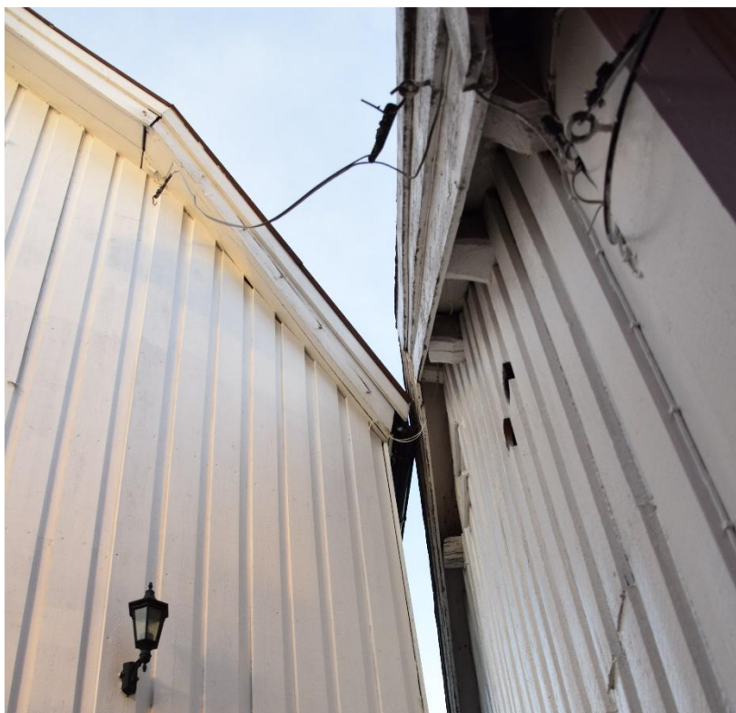
FIGUR 6: EKSEMPEL PÅ SVÆRT KORT AVSTAND MELLOM TO BYGNINGER. EN BRANN KAN RASKT SPRE SEG VIA ÅPNINGER I VEGG OG TAKUTSTIKK.
